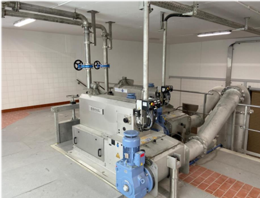
KA Liebenwalde Innenansicht des grundhaft sanierten Rechenraumes mit 2 Grimmel FFR 100
